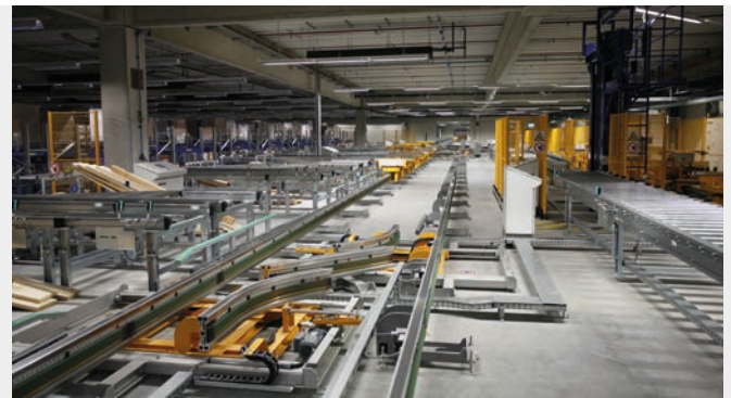
配有“超车道”的高架仓库库前区域。
